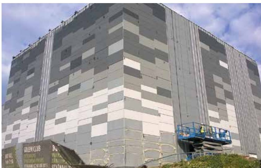
Zróżnicowane kolory w obrębie ściany
